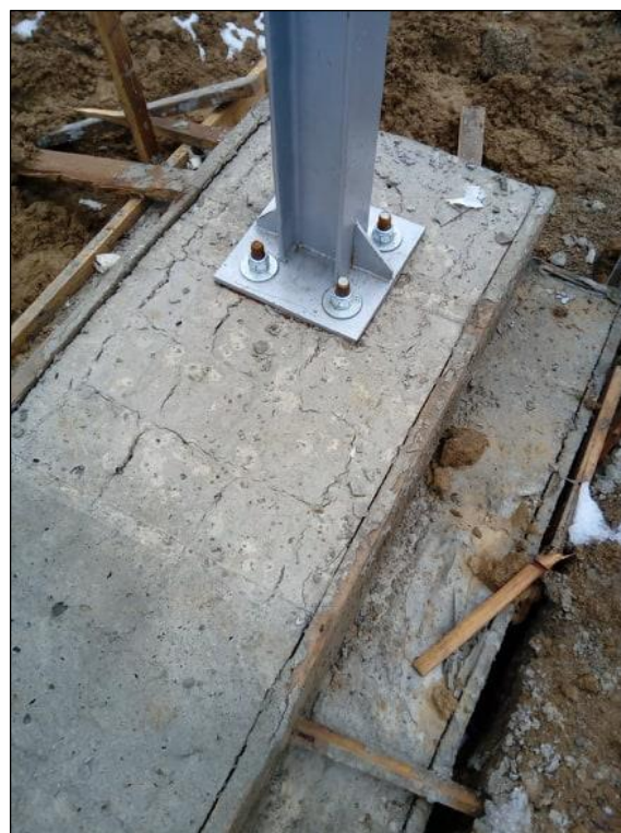
Fig. 4 – Fundația crăpată a totemului SCM
