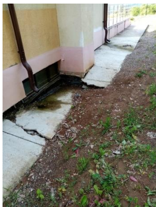
Figura 2a. Tasarea terenului și dizlocarea trotuarului din spatele clădirii principale (lunile februarie-iulie)
