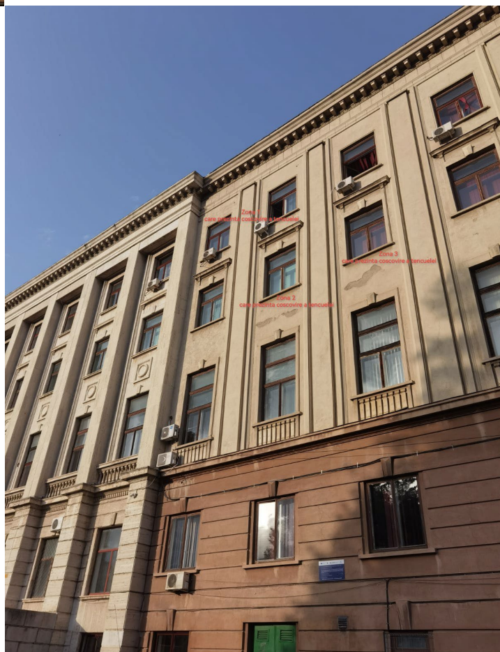
Latura din dreapta a fațadei cu porțiuni de tencuială deteriorată
